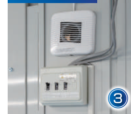
換気扇&ブレーカー
