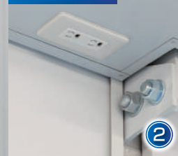
コンセント(天井)
